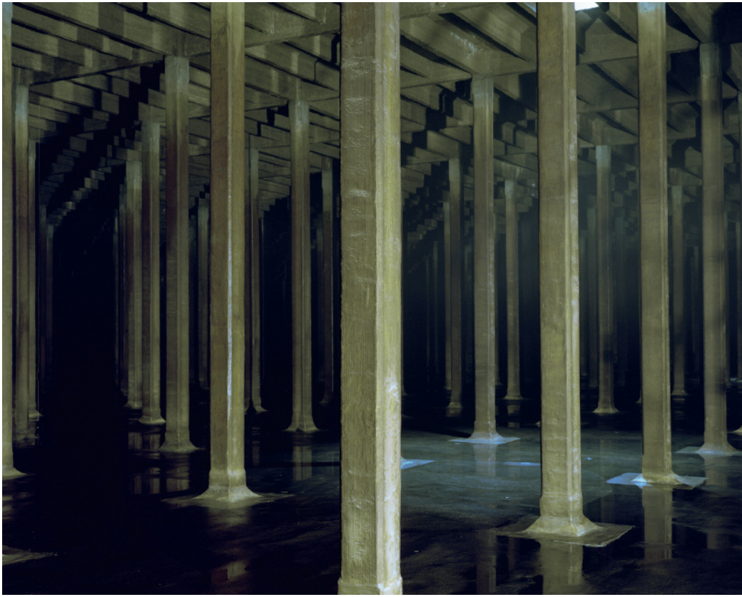
Réserve d'eau potable. SMPBR
