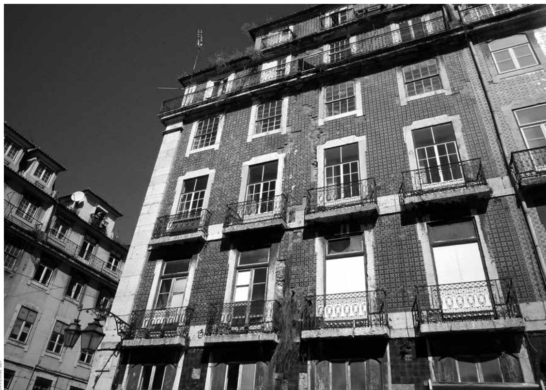
Façade dégradée dans le quartier la Baixa.
